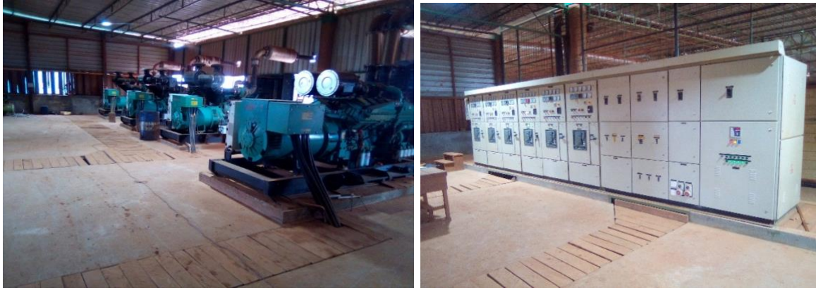
Figure 14: Vue des groupes électrogènes et de l'armoire de distribution
