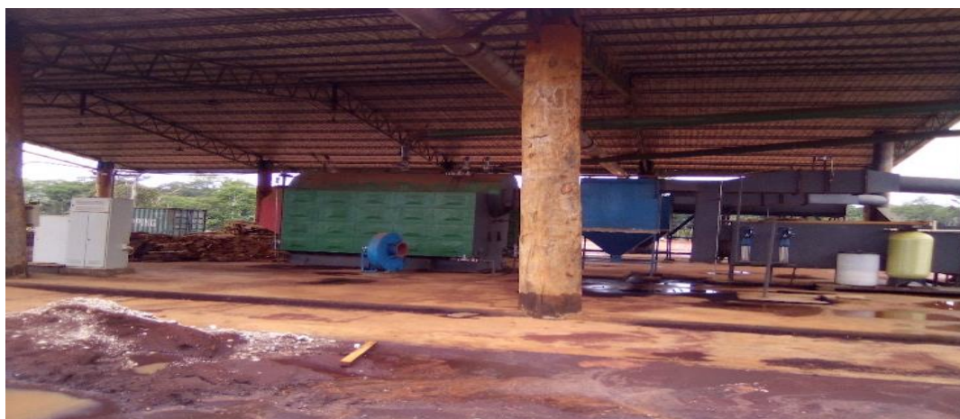
Figure 25 : Chaudière pour le sechage des bois sciés.
